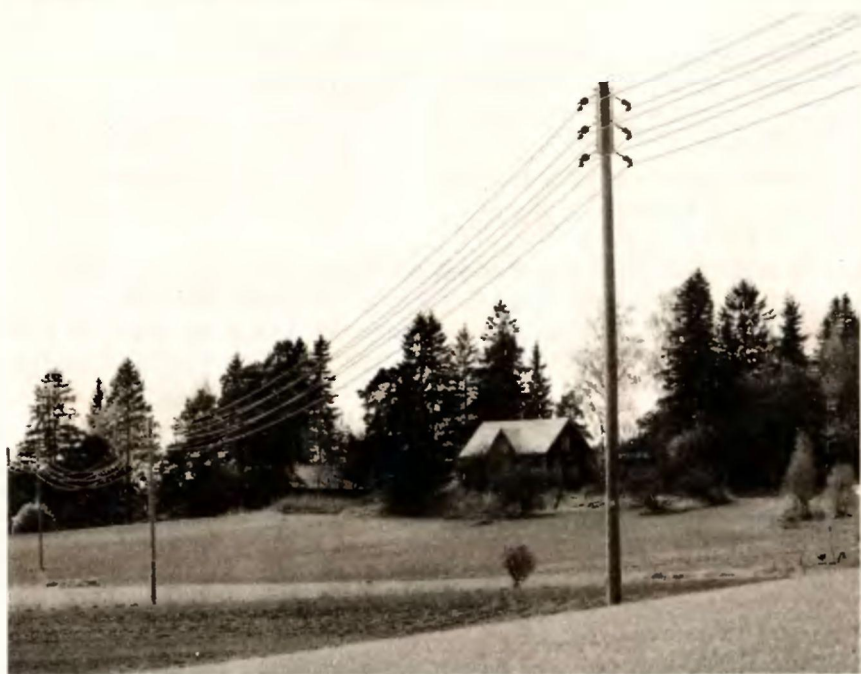
Рис. 13.39. Двухцепная линия напряжением 6...10 кВ (промежуточные опоры)
